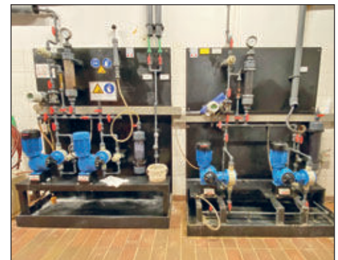
Dosieranlage für Natriumaluminat und Eisen-III-Chlorid mit Dosierpumpen
