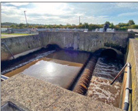
Zuführung von Natriumaluminat Verteilerbauwerk Belebungsbecken
