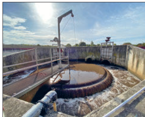
Zuführung von Eisen-III-Chlorid im Verteilerbauwerk Nachklärbecken
