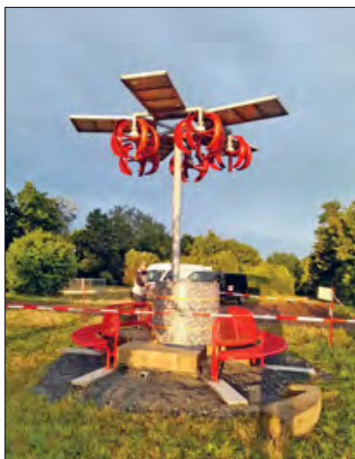
Aufbau der Ladestation (Foto: VWL Umweltzentrum für Haustechnik GmbH)
